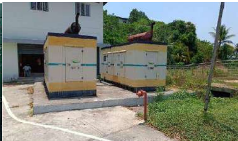
320 KVA DG Set
