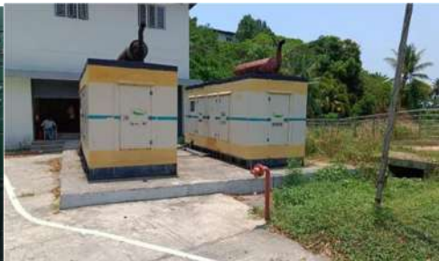
320 KVA DG Set
