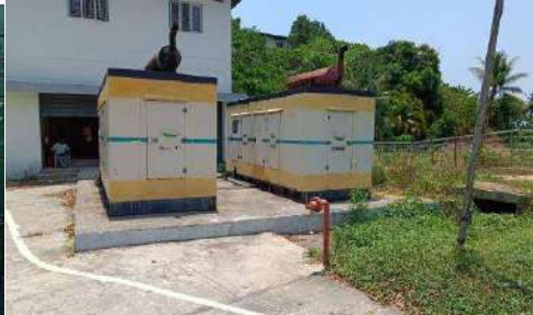
320 KVA DG Set
